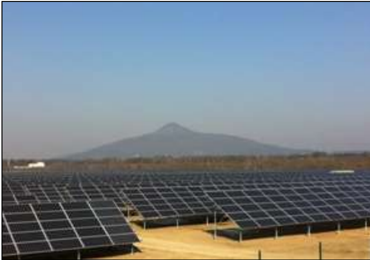
Obrázek 1: Fotovoltaická elektrárna v Mimoní
